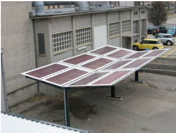
Réalisation d'un abri-vélos ; pas de ventilation requise la chaleur n'altérant pas le rendement.
