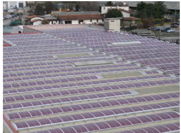
370 kW – Installation réalisée par Zanette Spa, Italie.
