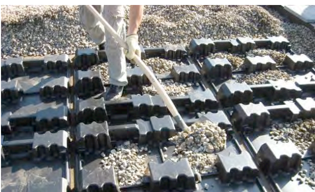
Les supports sont ballastés par le poids du gravier
