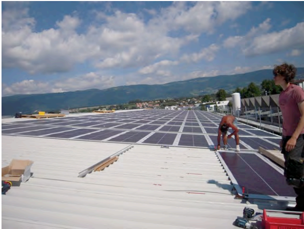
Couverture de grandes surfaces à prix compétitifs 86 kW - Installation réalisée par Solstis SA.
